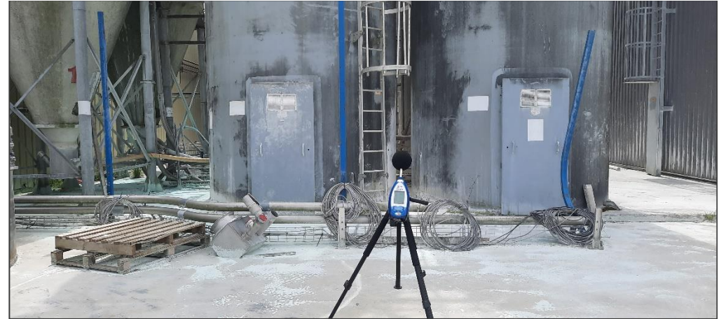
Pompes derrière portes des silos – Pt 19
