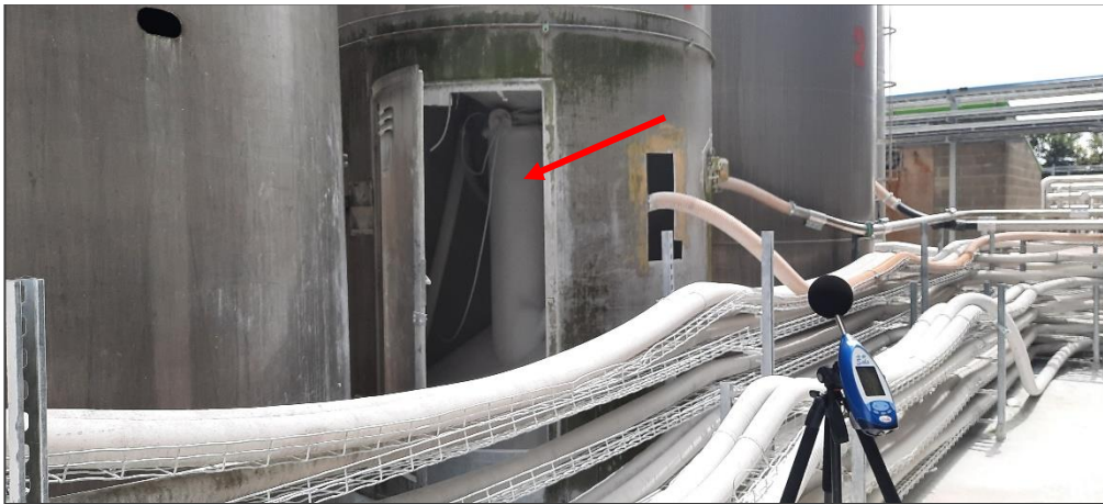
Pompe silo – Pt 20
