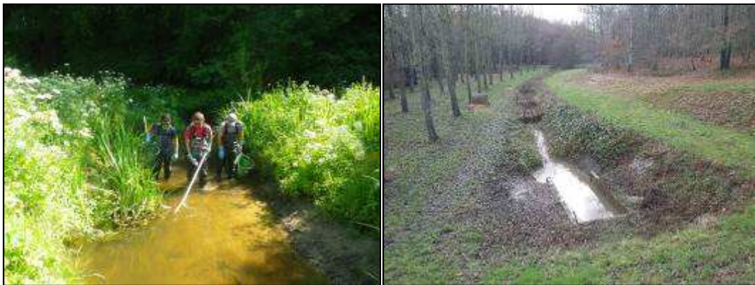
Figure 32 : Action de pêche électrique sur le Loc'h et mise en place de filtre à paille en amont d'une zone de travaux sur le Long
