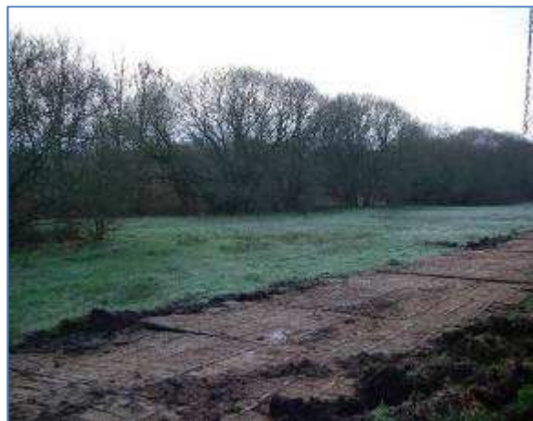
Figure 31 : Exemple d'un cheminement provisoire en bois qui protège le sol de la parcelle (bassin du Rion, chantier ERDF)
