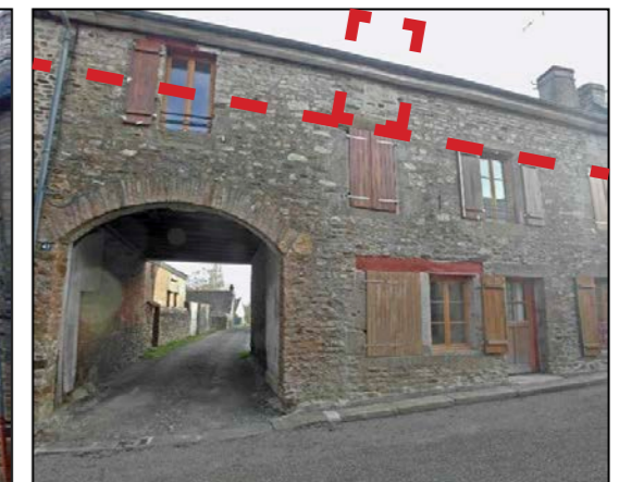
Fig.186 : Bâti rue de la Garenne - faubourg au Loup : dératellement modifié et lucarne supprimée
