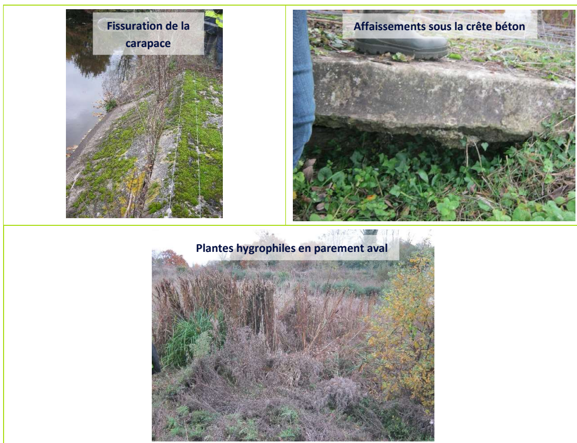
Figure 28 : Barrage de Pont-Avet – Illustration des désordres identifiés
