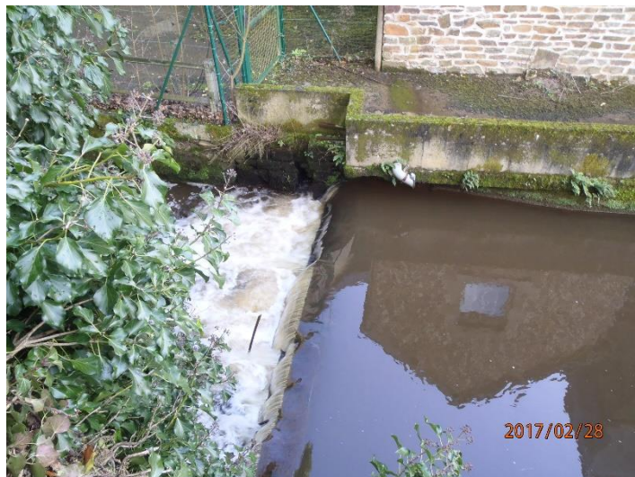
Figure 3 : Seuil de la laiterie Nazart - ROE 6140 (Fish-Pass, 2017)
