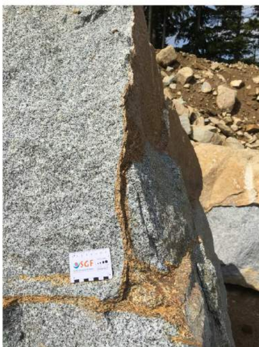
7731 - oxydation par infiltration dans les fissures (bloc isolé palier sup.)
