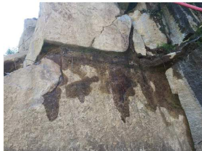
7718 - venues d'eau depuis les fissures et les joints horizontaux argilisés
