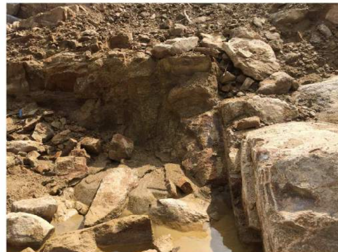
7734 - réseau de fissures E-W dans granite oxydé (palier sup.)
