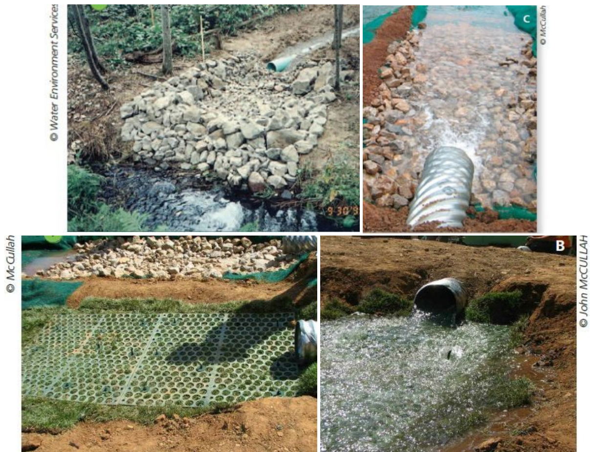
Figure 9 : En haut : Dispositifs temporaires de protection des points de rejet à l'aide de blocs En bas : Protection d'un point de rejet à l'aide d'un tapis laminaire PEHD. Le tapis favorise l'étalement de la lame d'eau et dissipe l'énergie hydraulique. Les faibles turbulences à la surface de l'eau permettent la reprise végétale, protégeant d'autant plus efficacement les sols contre l'érosion.
