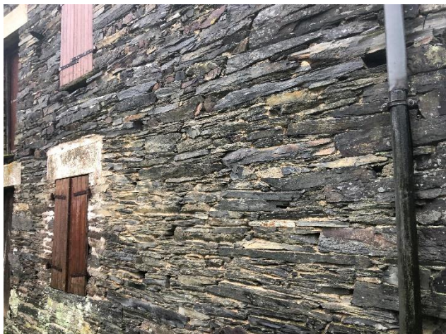
État du mur de la façade Est du bâtiment n°4 (nombreux interstices entre les pierres)
