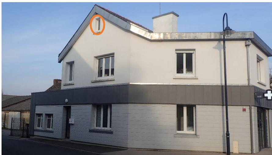
Remplacement de la fenêtre par une planche en bois avec passage à chiroptère (source : Commune de Sainte-Marie et CERESA, le 02-03-2023)
