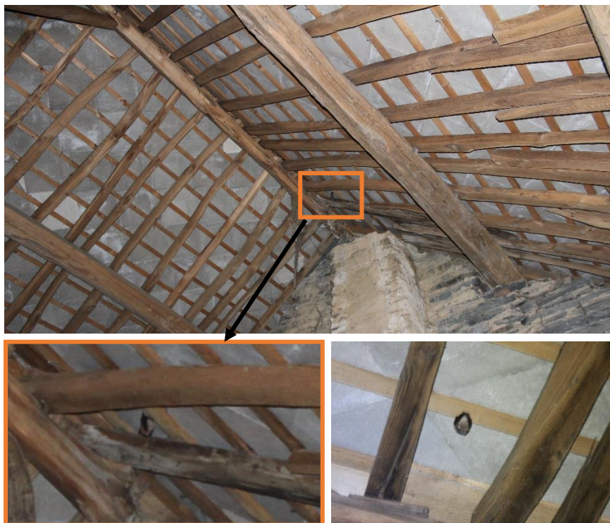
Exemple des grands volumes constatés dans le bâtiment en ruine (source : et CERESA, le 21-06-2022 et les 25-05-2022)
