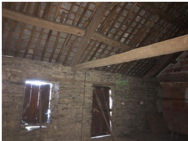
Jour entre le mur, la lucarne et la porte situé dans le comble du bâtiment n°4
