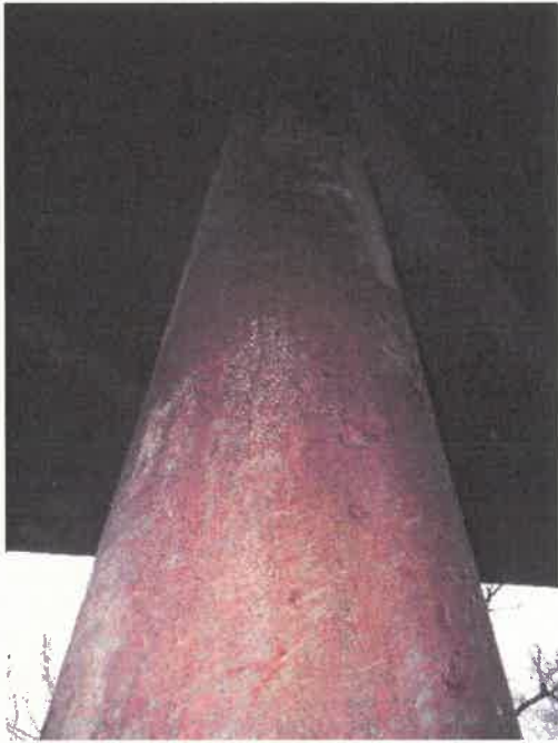
Les poteaux béton semblent être amiantés avec un coffrage perdu en amiante.
