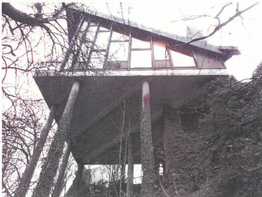
Les façades du restaurant sont principalement composées d'épines bois pour la fixation des menuiseries toute hauteur.
