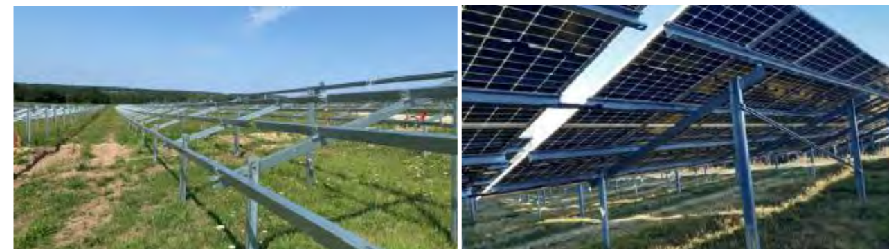
Figure 14 : Structures porteuses des tables de modules en acier (crédit : VALECO).
