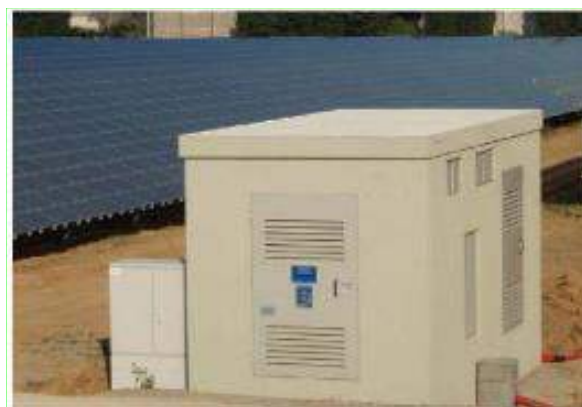
Figure 113 : Exemple d'un poste de livraison
