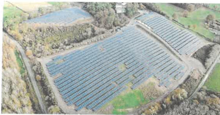
Photographie de la centrale solaire d'Energ'iv, située à Guignen.
