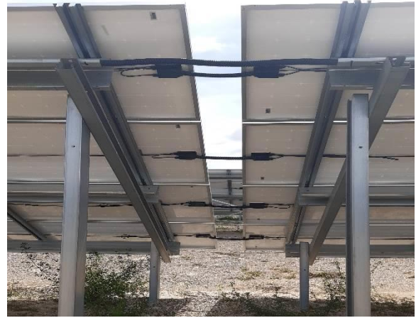
Figure 8: Câblage sous modules
