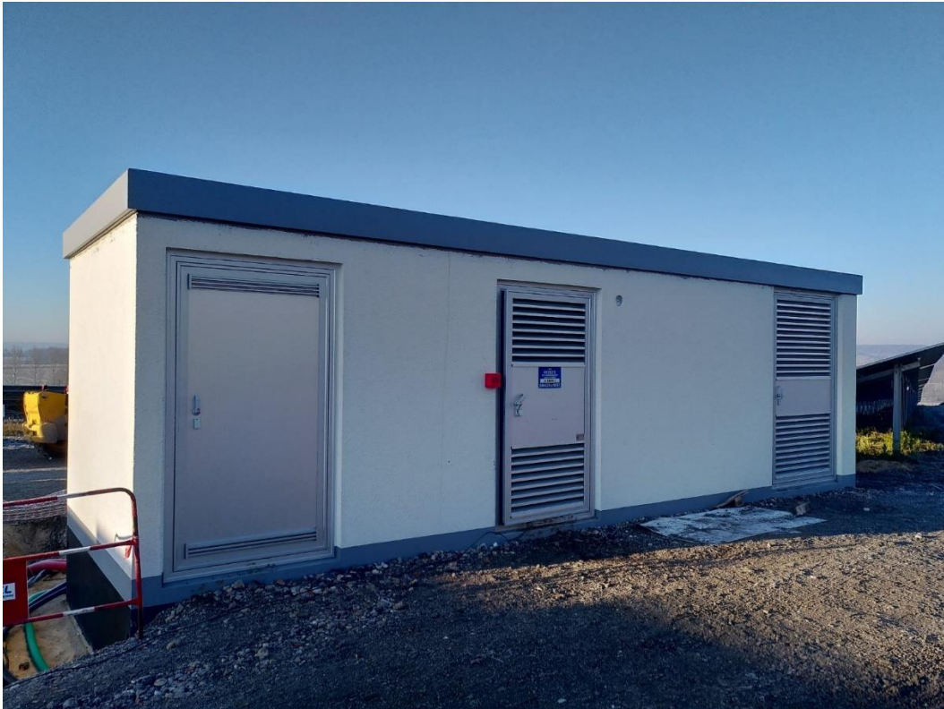
Figure 11: Photographie d'un poste de livraison/transformation
