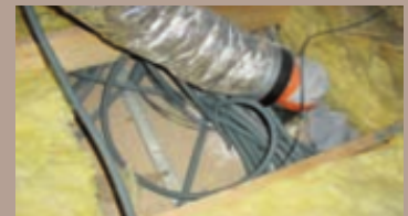
Un défaut d'isolation thermique réduisant les économies d'énergie prévues
