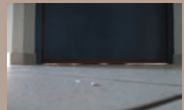
Un défaut de pose de la porte d'entrée générant une isolation thermique et sonore déficiente
