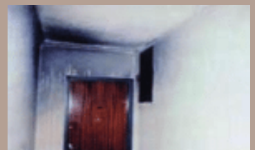
Une évacuation des fumées impossible générant un risque d'intoxication non négligeable
