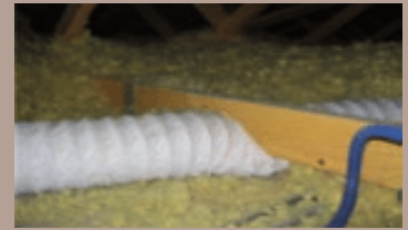
Une ventilation mécanique inopérante pouvant entraîner un développement de moisissures
